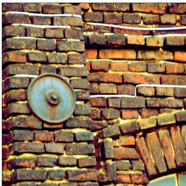
Anker in den Mauerwerken halten das alte Gemäuer zusammen. Man sieht, wie eilig und wahrscheinlich nicht von Fachkräften damals Fabriken zusammengemauert wurden.
